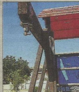
Una de las piezas está estropeada.
