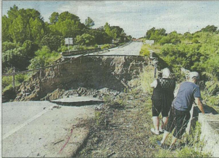
Tramo de carretera gravemente dañado por la riada de octubre. BIEL CAPÓ
