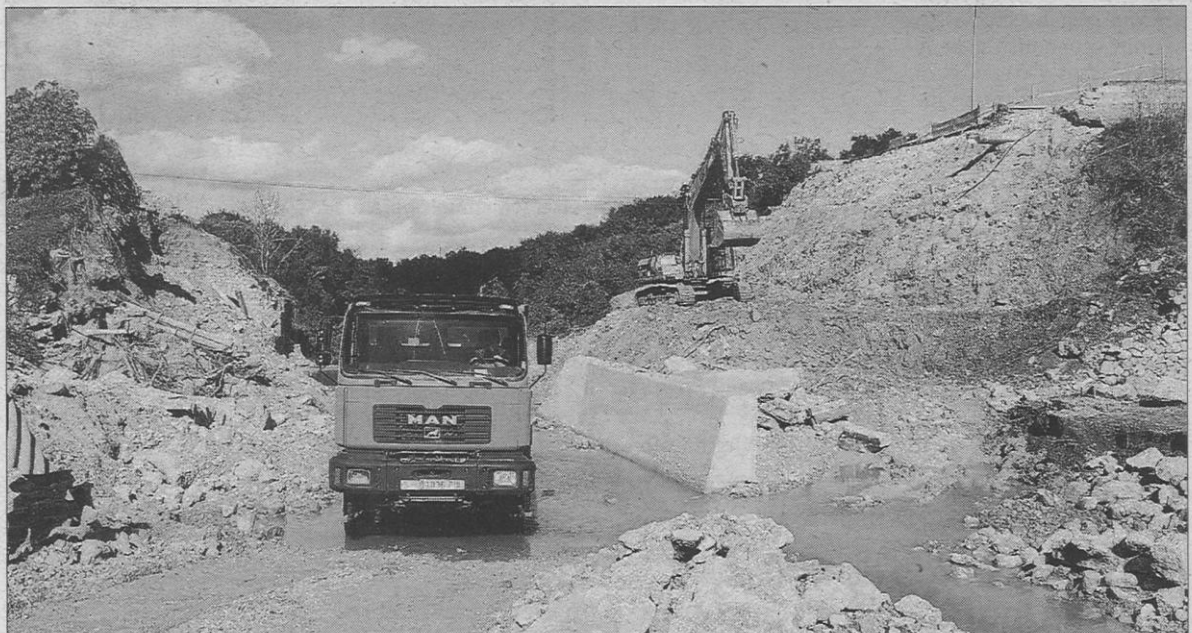
Imagen de ayer de las obras en el cauce del torrente que cruzaba la carretera de la Colònia. Foto: ABASSA
