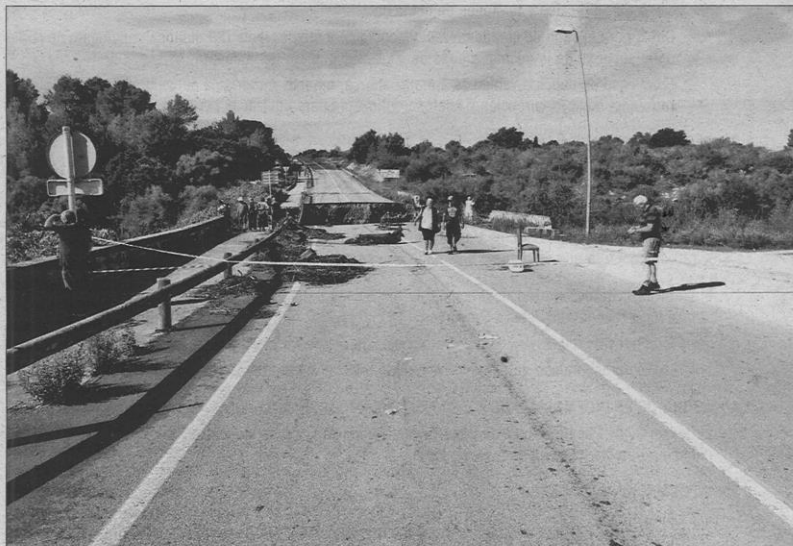
Carretera de Artà a Sant Llorenç. Vecinos y turistas observando ayer el agujero de la vía. B. CAPÓ
