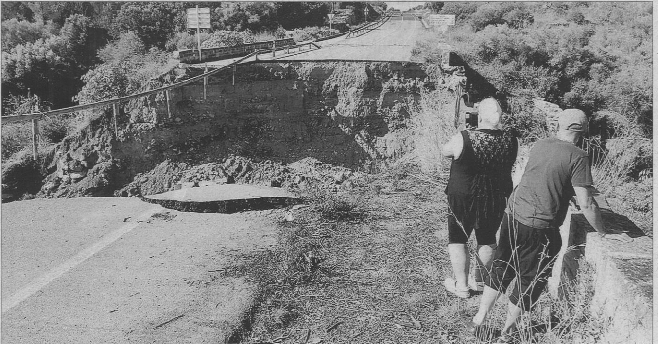
Carretera de Artà a la Colònia de Sant Pere. Unos vecinos fotografiando ayer el socavó que provocó la gran 'torrentada' del pasado martes. B. CAPÓ
