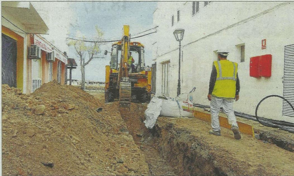
Imagen de archivo de las obras de instalación de una canalización de pluviales en un municipio de Balears.
