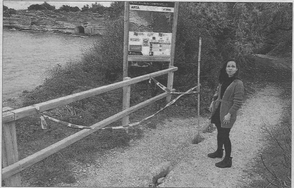
La regidora de Medi Ambient, Aina Comas, en la zona donde hay las profundas grietas.
